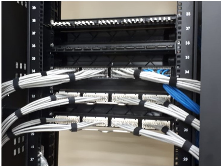
Organização traseira. Chegada dos cabos.
